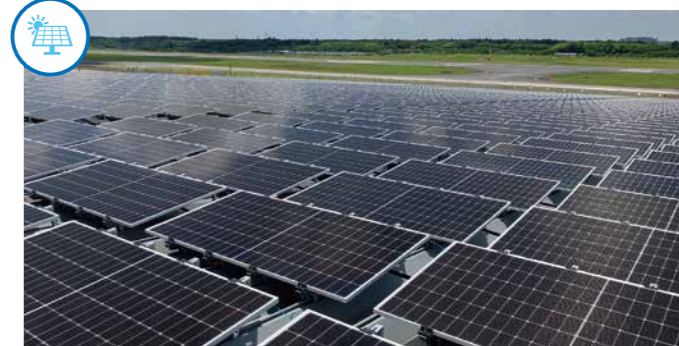
太陽光発電システム Photovoltaic power generation system
