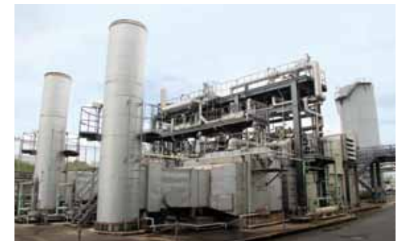
コージェネレーションシステム
