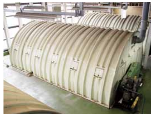
厨房排水除害施設
