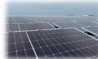
太陽光パネル
