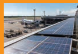
④ 太陽光発電パネル
