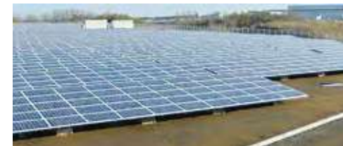
三里塚太陽光発電所
