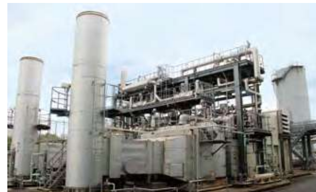
コージェネレーションシステム
