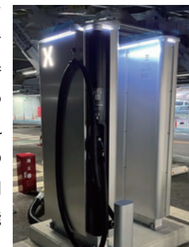
第1ターミナル立体駐車場の蓄電池式超急速EV充電器
