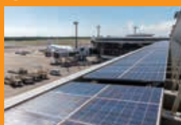
④ 太陽光発電パネル
