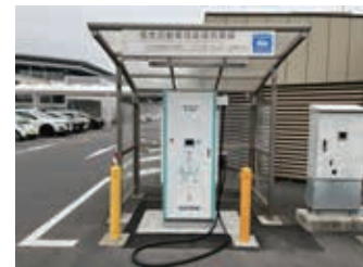
急速EV充電器
